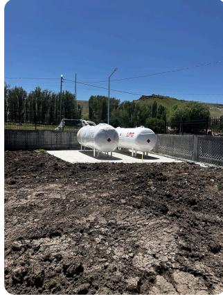
LPG tank sahası
